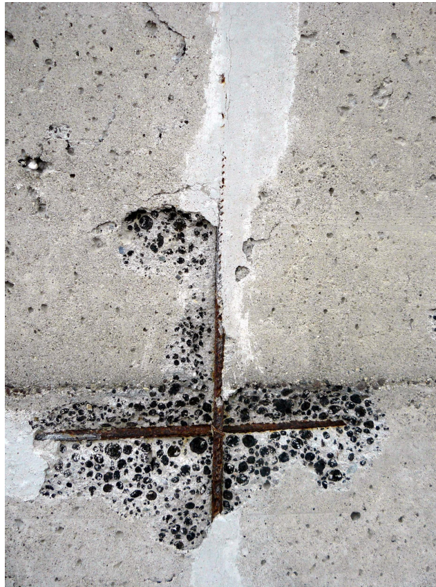
Un “Leca-béton” à l'épreuve du temps et des mauvaises réparations (photo G. Jean)
